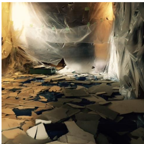
④石膏ボードの残骸
