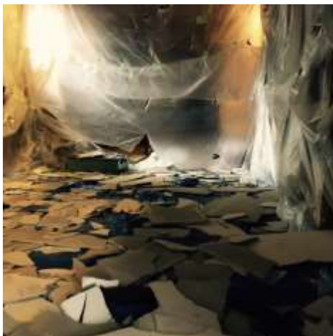
剥ぎ落した天井の石膏ボード
